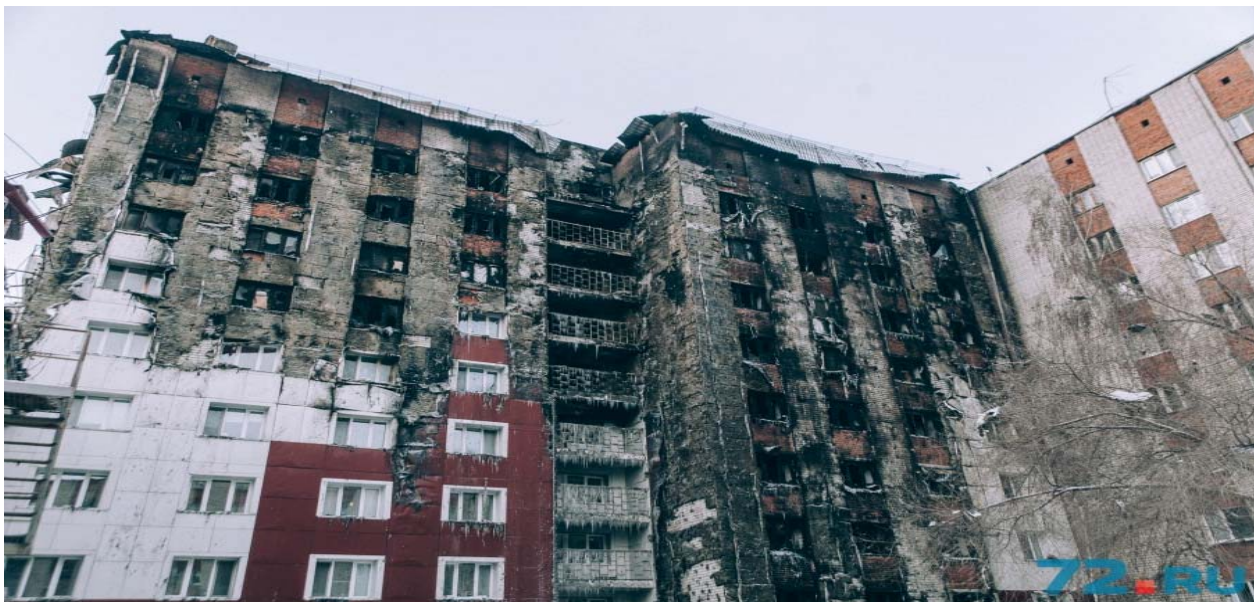
Рис. 2. Фасад здания после пожара
