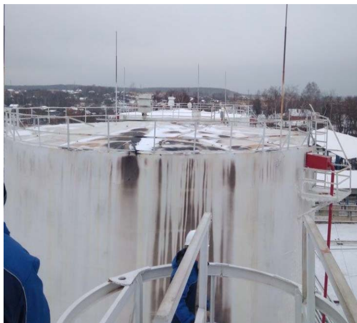
Рис. 1. Последствия воспламенения газозоудной смеси на резервуаре РВС-2000
